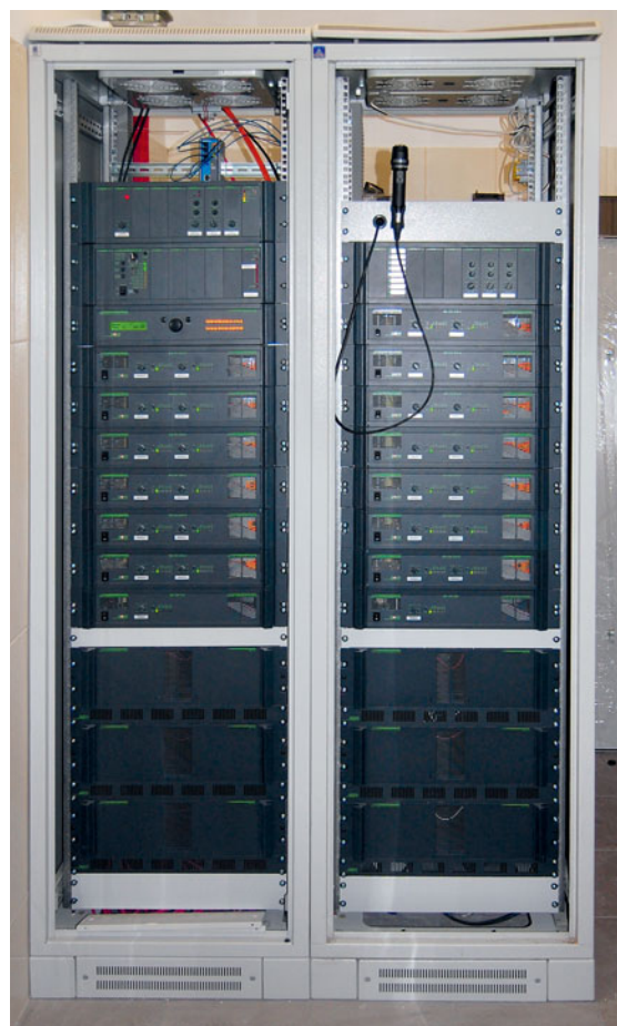
Sercem systemu DSO jest amplifikatornia, w której zainstalowano system APS Aprosys firmy g+m elektronik oraz 13 wzmacniaczy g+m elektronik BO-CD 250-2EV plus dwa rezerwowe.
