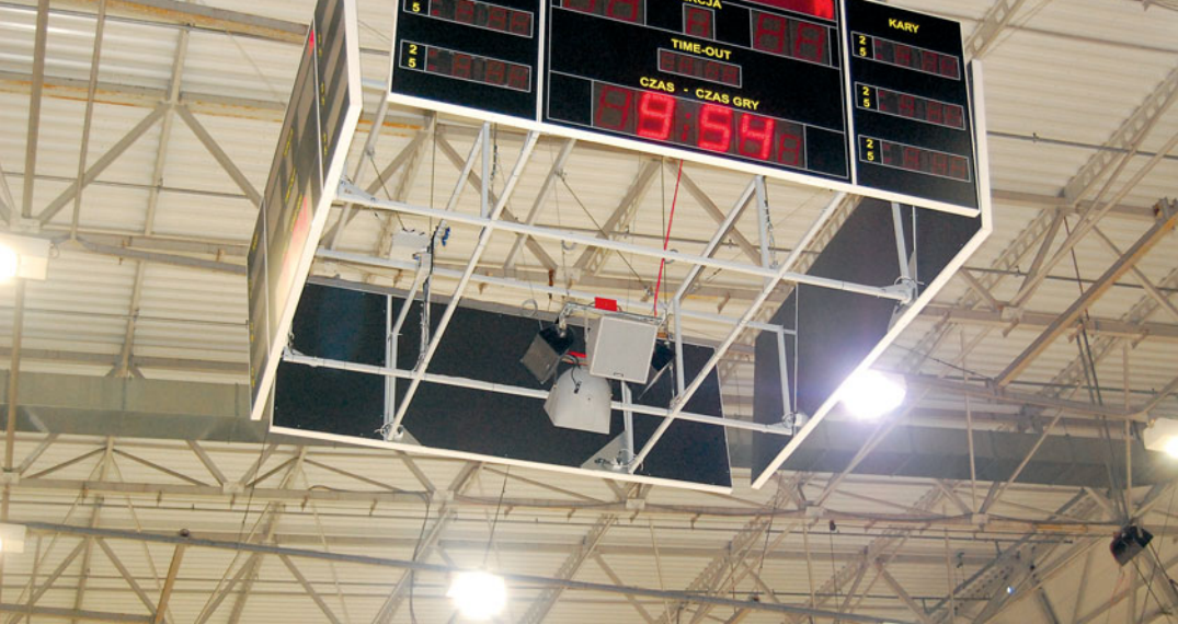
Centralnie nad płytą lodowiska zawieszono dwa zestawy głośnikowe Community R.5 oraz dwa szt. Community WET 228.
