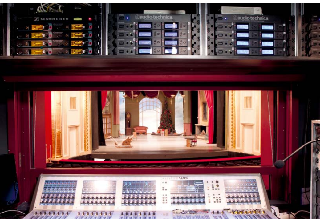
W kabinie akustyka zabudowano również 24 bezprzewodowe systemy mikrofonowe firmy Audio-Technica i 8 bezprzewodowych systemów odsłuchowych Sennheisera.
