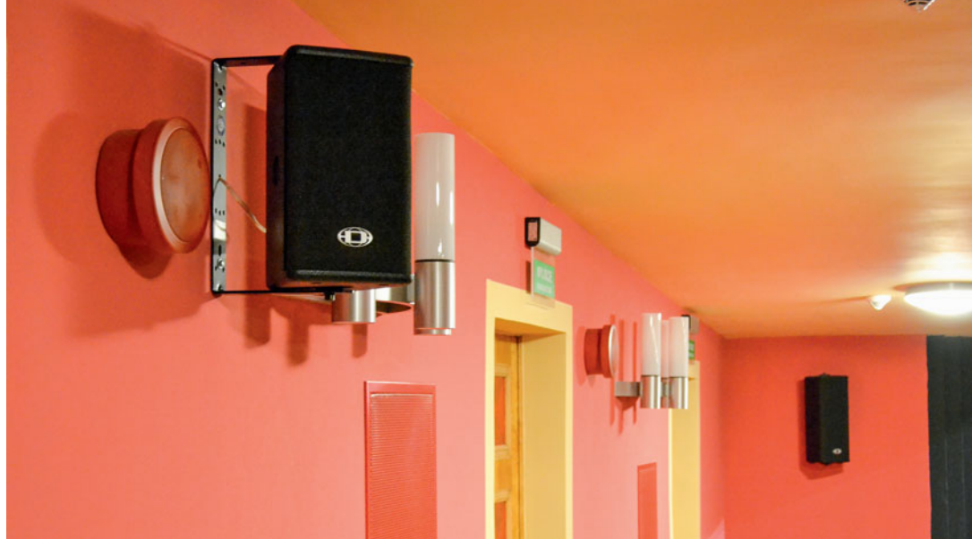
Aby wypełnić dźwiękiem obszary pod balkonem, likwidując tym samym powstałe tam niekorzystne „cienie” akustyczne, zastosowano boczne zestawy dogłaśniające.
