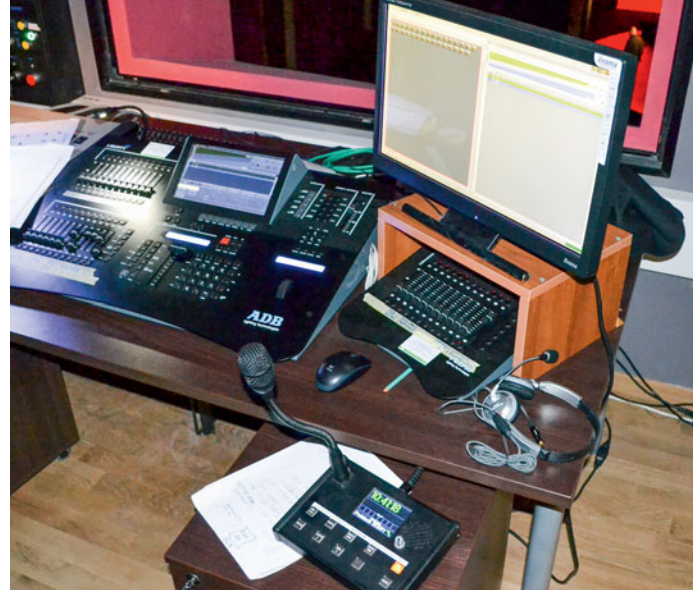
System oświetleniowy na Dużej Scenie sterowany jest z konsoli ADB Liberty z dodatkowym wingiem Hathor 24 Subfader Extension Module.
