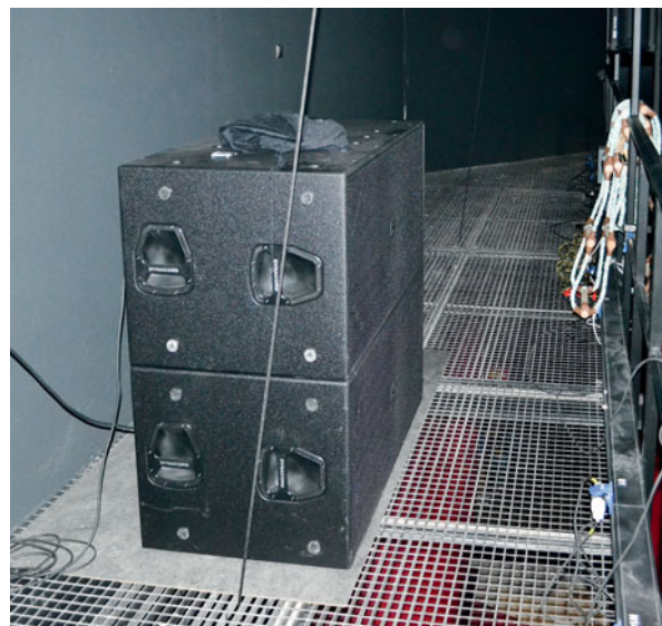
...zaś dwa subwoofery SUB 28 są przeważnie umieszczone nad sceną, na pomoście technicznym.
