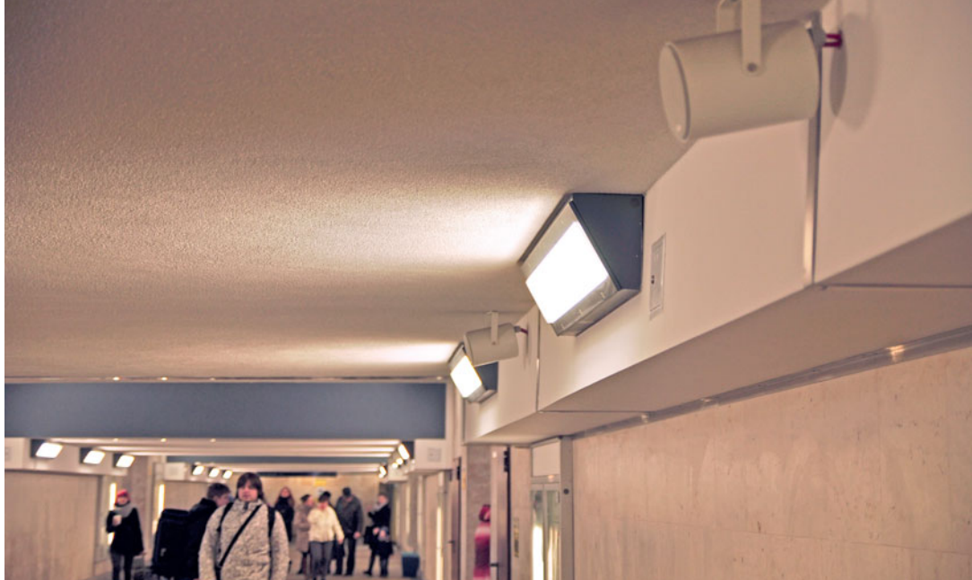
W podziemnych tunelach znajdziemy naściennne projektory dźwięku BOSCH LBC 38-42.
