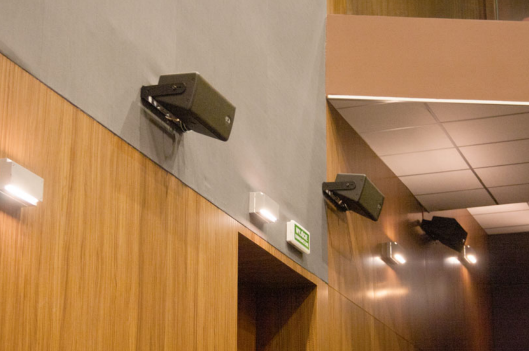
Rolę głośników surroundowych pełni dwanaście zestawów Dynacord VL262, rozmieszczonych wokół widowni.
